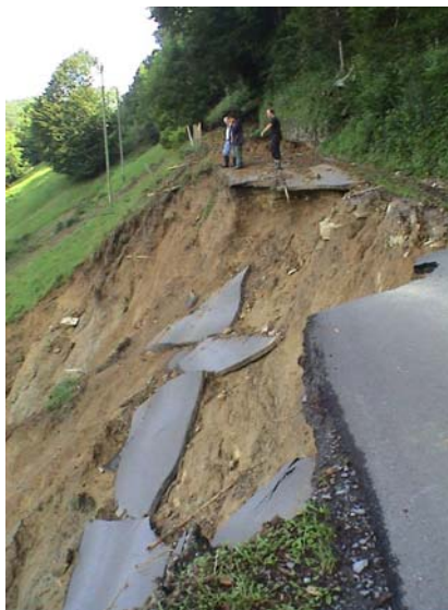
SZ Arth: accès de ferme détruit
