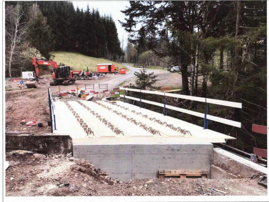
SZ, Arth, Rigi, Fruttli Brücke über die Rigiaa in Holz und UHFB April 2021, 16 m Spannweite, 40 t CHF 255'000 (ohne Widerlager)
